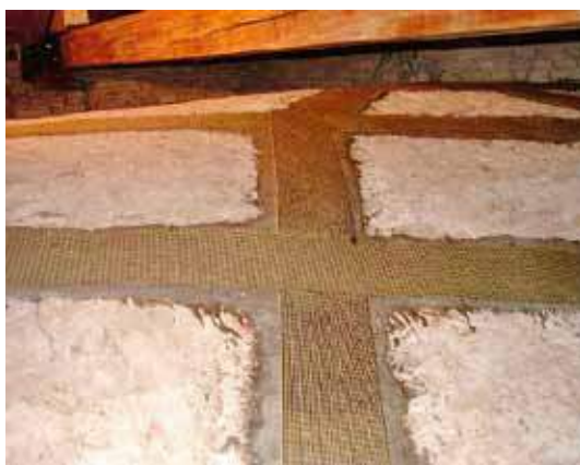
357 L'estradosso delle volte e la cerchiatura della cupola della cappella del Rosario con fasce di carbonio. Foto di U. Turrini
